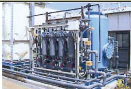
地下水膜濾過システム （災害時の為の飲料水）
