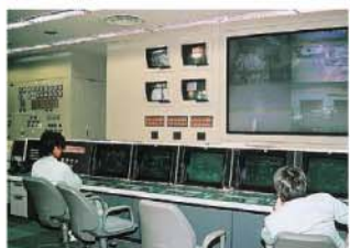
▶中央制御室では、焼却炉やクレーンなどの運転を最新のコンピュータでコントロールしています。
