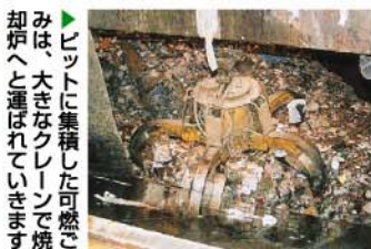
▶ピットに集積した可燃ごみは、大きなクレーンで焼却炉へと運ばれていきます。
